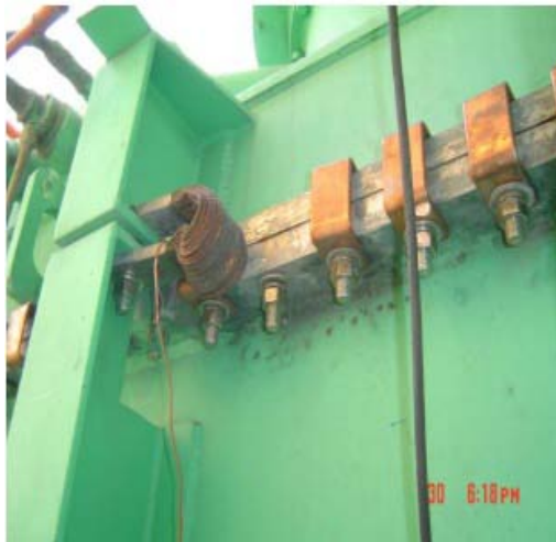
Fig. 4. Puentes de soleras de cobre para unir la tapa con el tanque del transformador que permitieron reducir el incremento de temperatura del conjunto brida-tornillo de 387°C a 84°C en el transformador bajo estudio.
