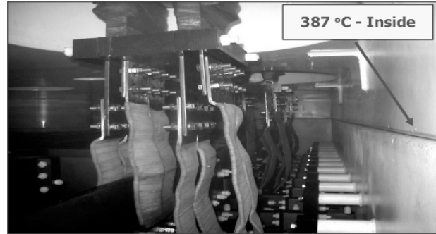
Figura 2. Interior del transformador. La flecha muestra la región de la unión brida-tornillos.
